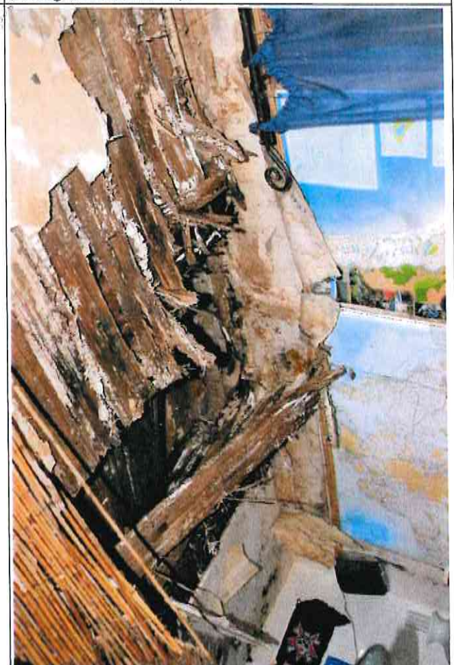
Obergeschoss WE 2,3 Feuchteschaden Decke
