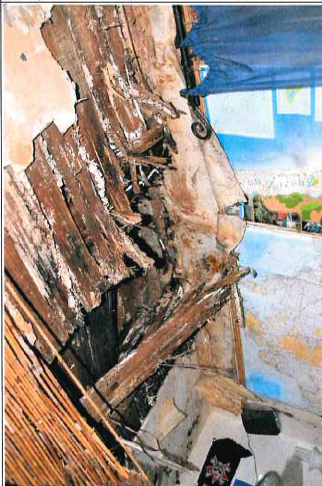
Obergeschoss WE 2,3 Feuchteschaden Decke
