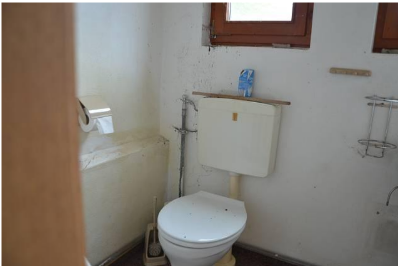
Foto 26 WC FÜR LAGERBEREICH
