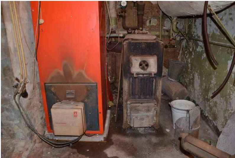
Foto 28 HEIZUNG FÜR LAGERBEREICH
