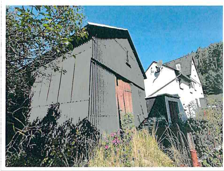
5) Nebengebäude / Scheune aufgrund Bauzustand symbolisch 1,- EUR
