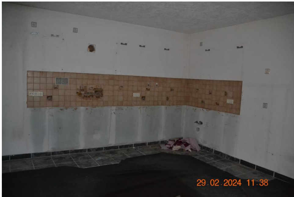
Bild 15: Küche 1. Obergeschoss, stark renovierungsbedürftig
