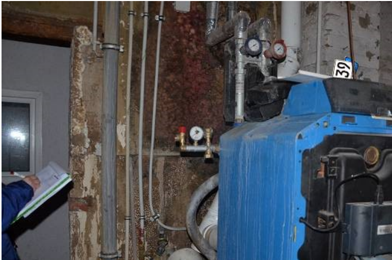
FOTO 13 HEIZUNGS- UND ABSTELLRAUM IM ERD-GESCHOSS ANBAU
