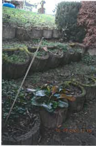
schadhafte, rückwärtige Betonpflanzsteine
