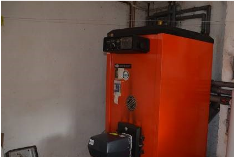
Foto 16 HEIZUNG IM EHEMALIGEM STALL
