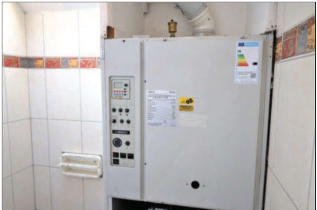
DG – Bad mit Gaszentralheizung
