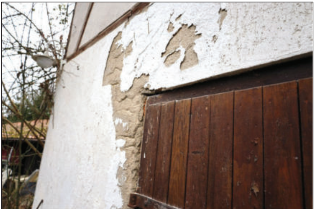
Putzschäden Fassade – Nebengebäude mit Anbau
