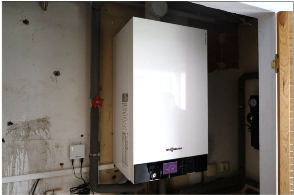
Gaszentralheizung im Anbau
