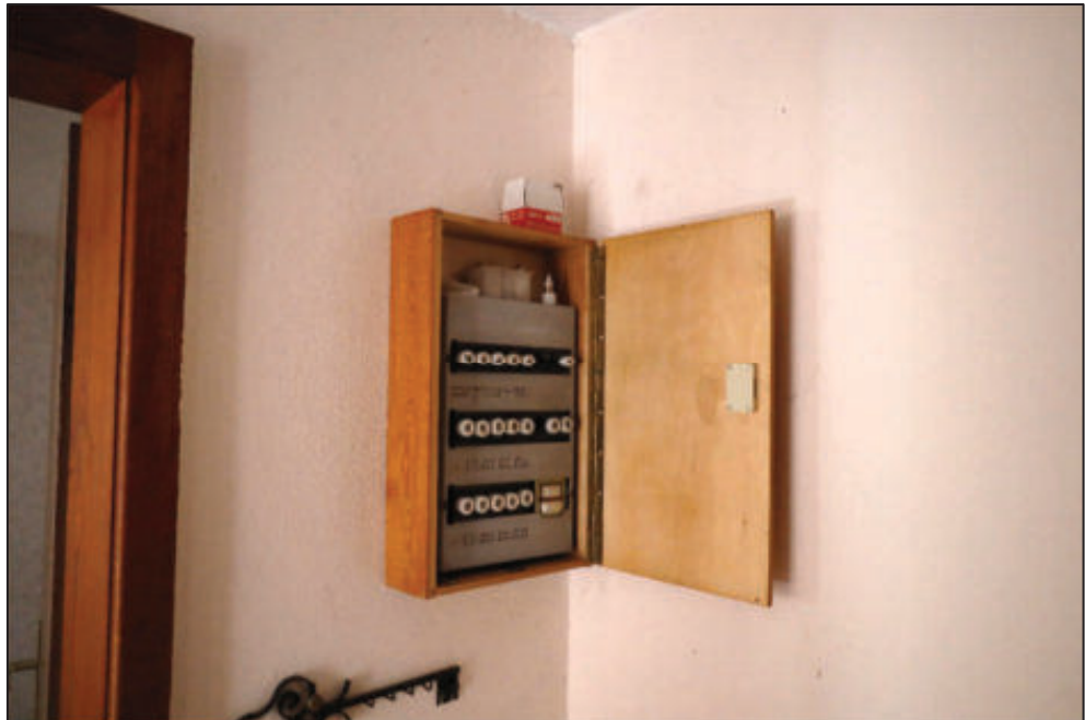
Hinterhaus – Sicherungskasten WE 3 (EG)
