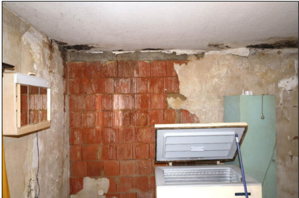
Feuchtigkeitsschäden im Anbau - EG
