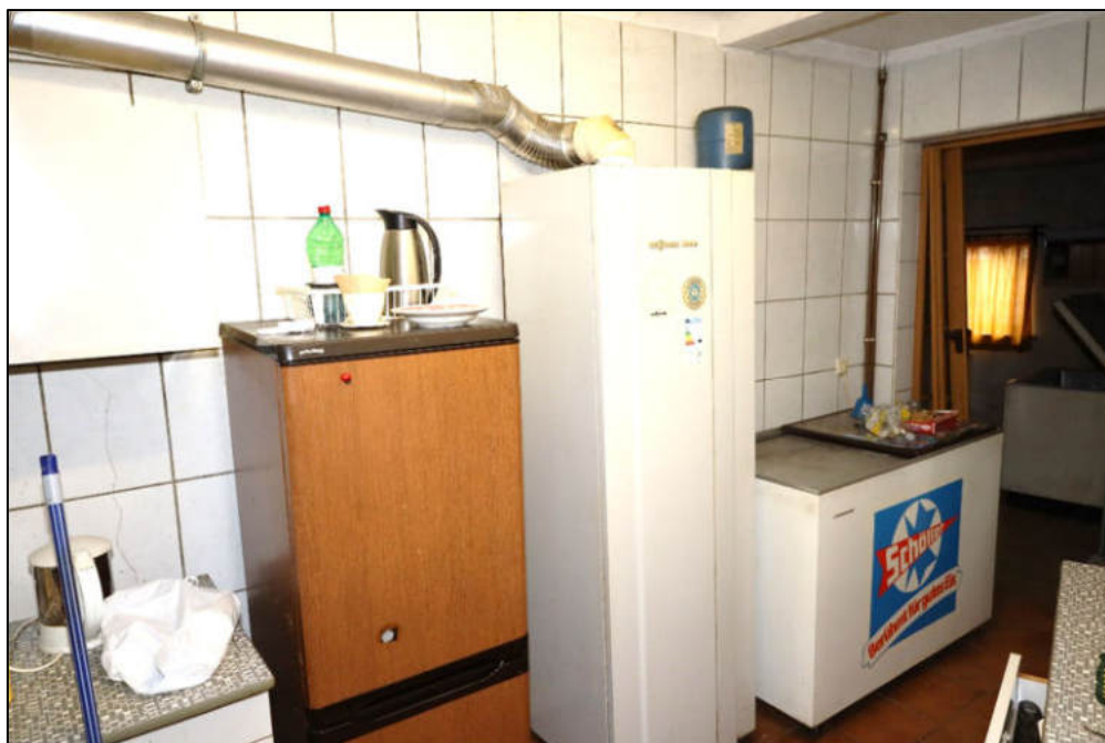
Küche mit Gaszentralheizung - EG
