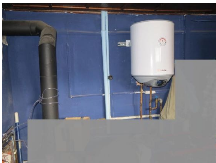
EG Waschküche mit Warmwasserboiler
