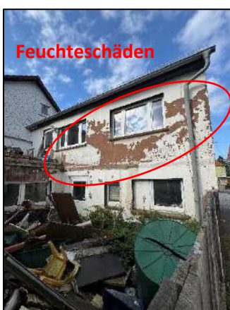
Feuchteschäden an der Fassade der Hausrückseite
