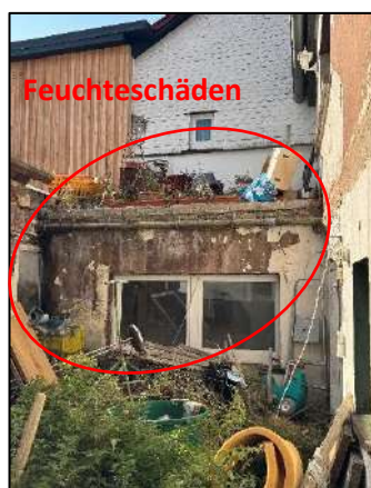
Feuchteschäden an der Außenwand und Decke des Anbaus
