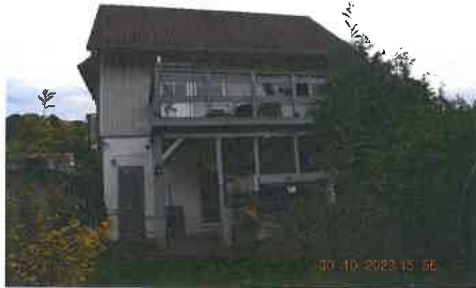
rückwärtige Gebäudeansicht mit nicht genehmigtem Balkonanbau
