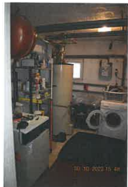
Heizungsraum im angrenzenden Gebäude auf Fremdgrundstück Flurstück 437/1
