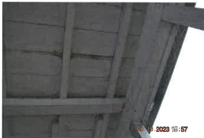
schadhaftes Holz Balkonbereich Unterseite
