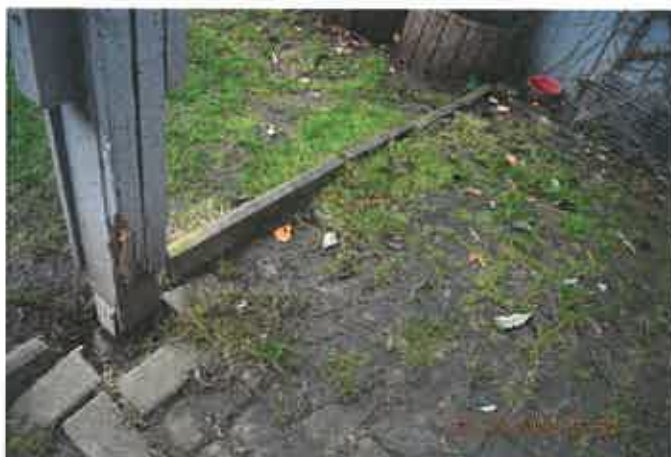
schadhafte Stützfeiler Holz balkon
