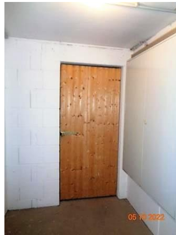
Bild 8: Tür zum Keller Nr. K 5 im Eingang Prießnitzstraße 9; der Keller konnte zum Ortstermin am 05.10.2022 besichtigt werden; auf Grund von Einlagerungen im Keller eingeschränkte Besichtigungsmöglichkeit
