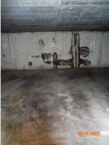
Bild 5: Tiefgaragenstellplatz Nr. P 20 mit älterem Feuchteschaden an Stahlbetonelementen zwischen Stellplatz Nr. P 20 und P 21
