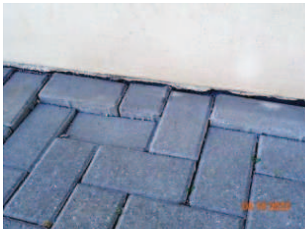
Bild 14: Gehwegpflaster vor dem Gebäude teilweise Absenkungen und Unebenheiten
