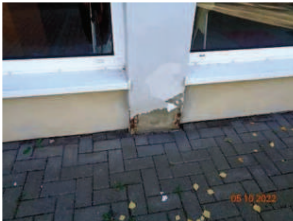
Bild 11: Putzschäden Spritzwasserbereich Wohn- und Geschäftsgebäude Eisenacher Straße 61; gebäudenordseitig
