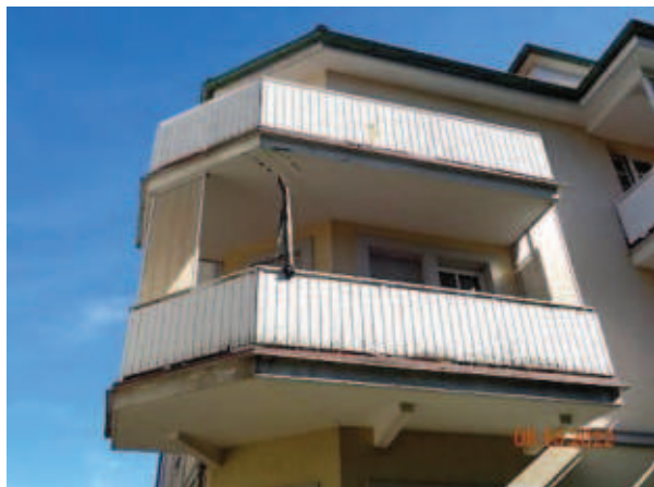
Bild 13: Balkone zum Teil mit Verwitterungserscheinungen
