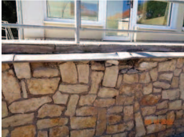
Bild 17: Fehlstellen / Schäden an Natursteinverkleidung Stützmauer ostseitig vor dem Gebäude
