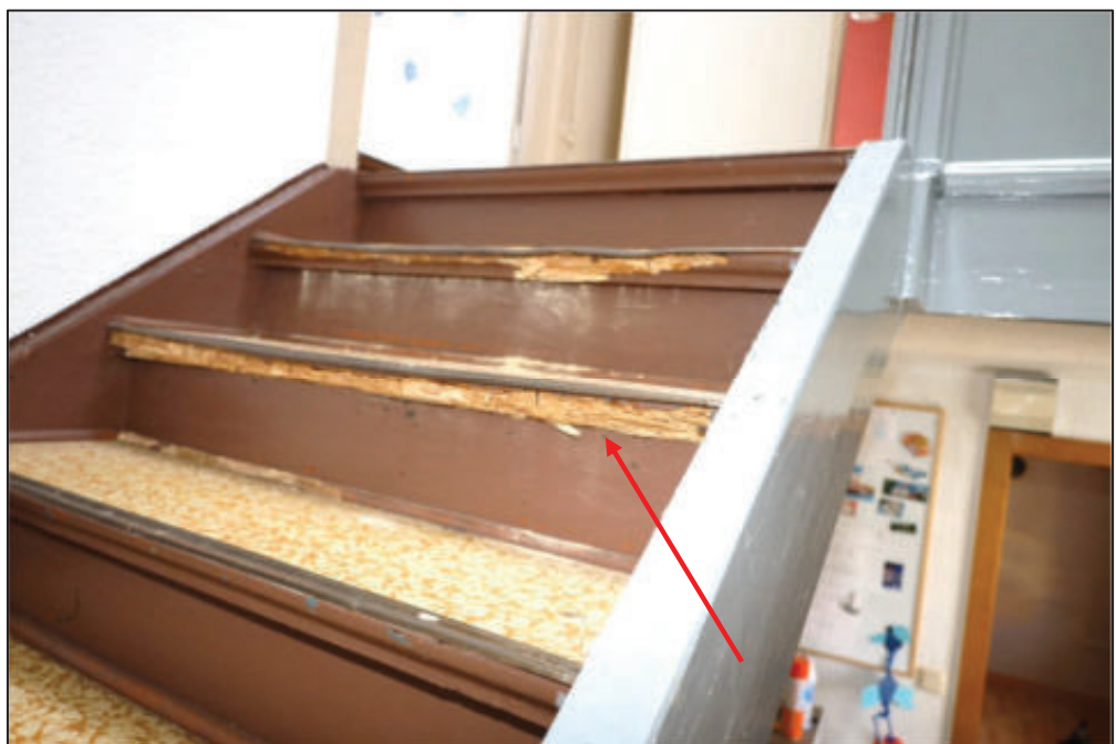
Treppe zum DG mit Holzschädlingsbefall
