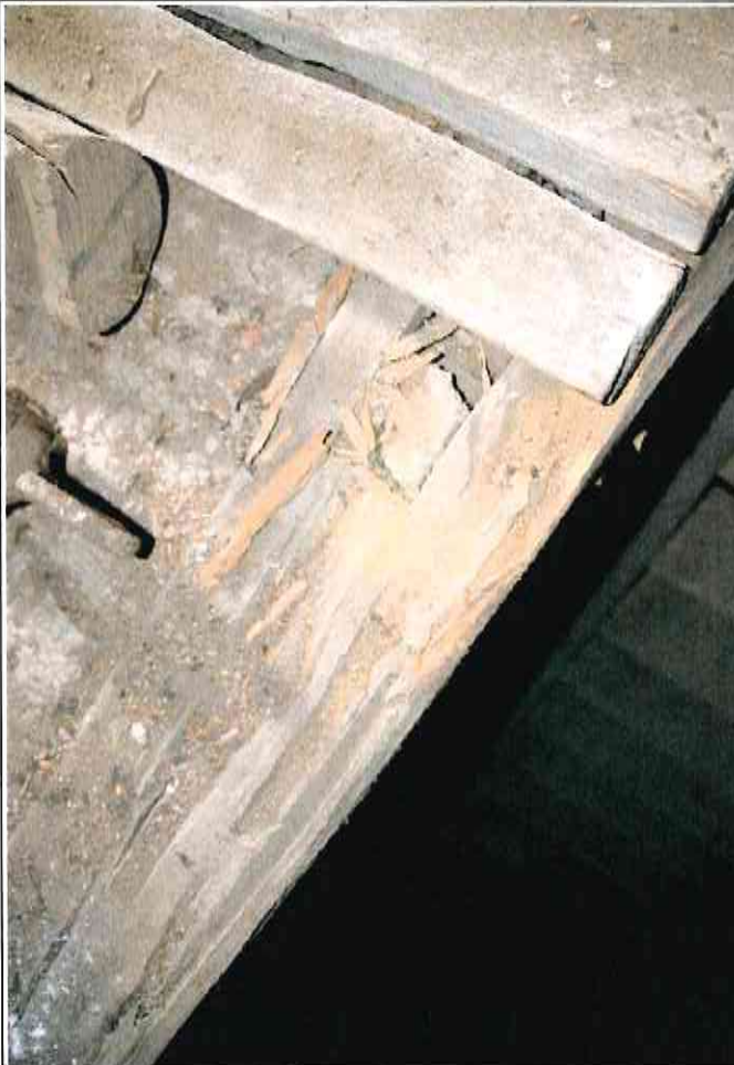
Dachgeschoss- Befall durch tierische Holzschädlinge
