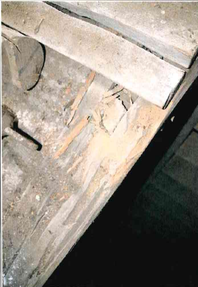
Dachgeschoss- Befall durch tierische Holzschädlinge
