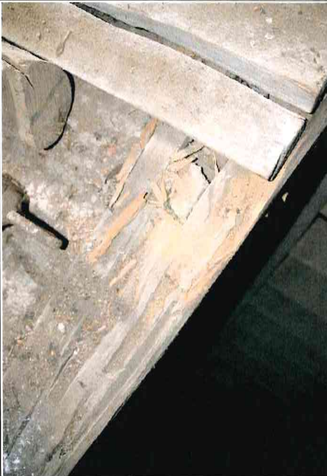
Dachgeschoss- Befall durch tierische Holzschädlinge
