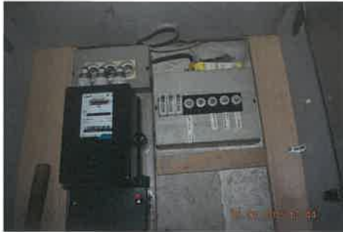
E-Verteilung im Dachgeschoss
