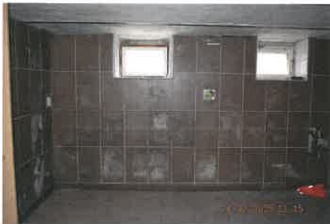
Raum mit Sperrholzplattenverkleidung und Schimmelschäden
