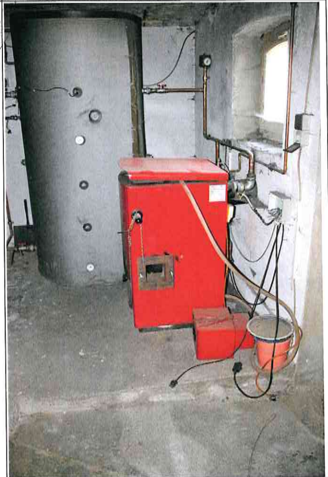
Wohnhausanbau Erdgeschoss Heizungsraum
