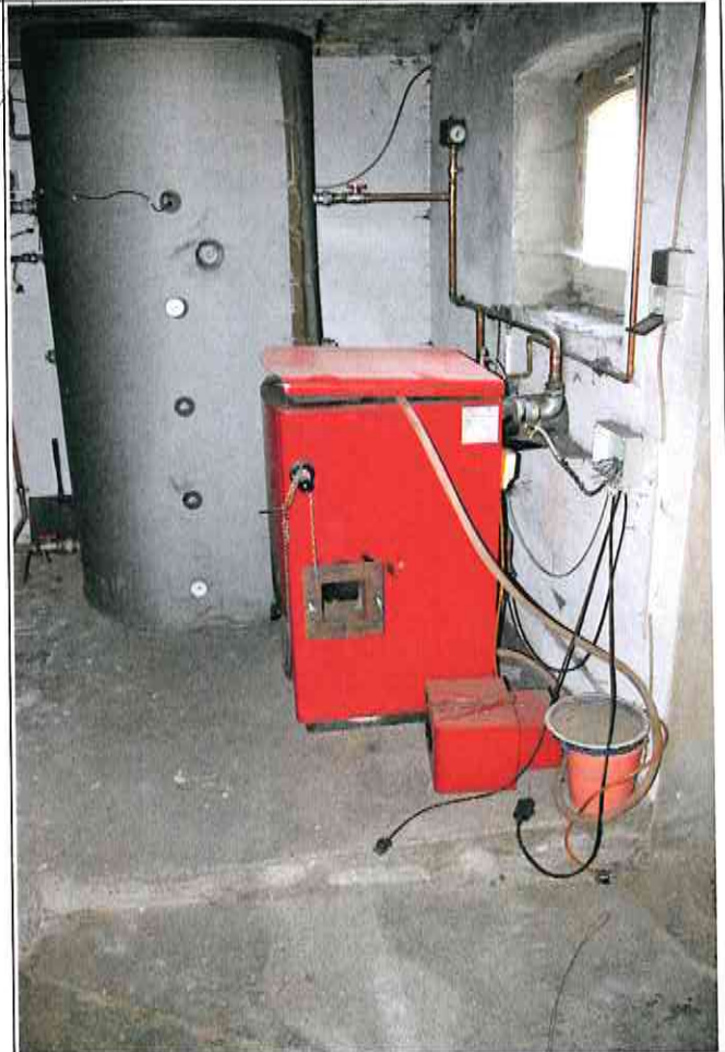
Wohnhausanbau Erdgeschoss Heizungsraum
