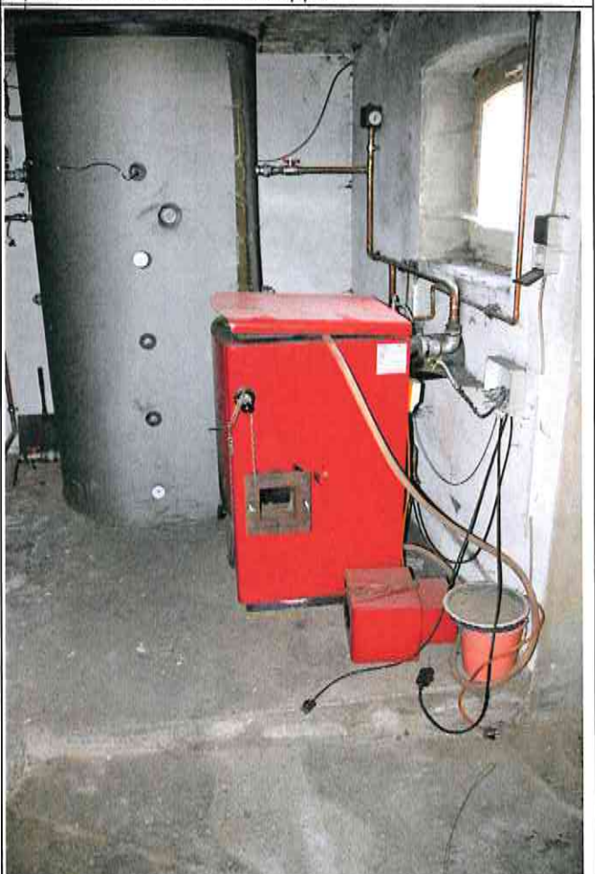
Wohnhausanbau Erdgeschoss Heizungsraum
