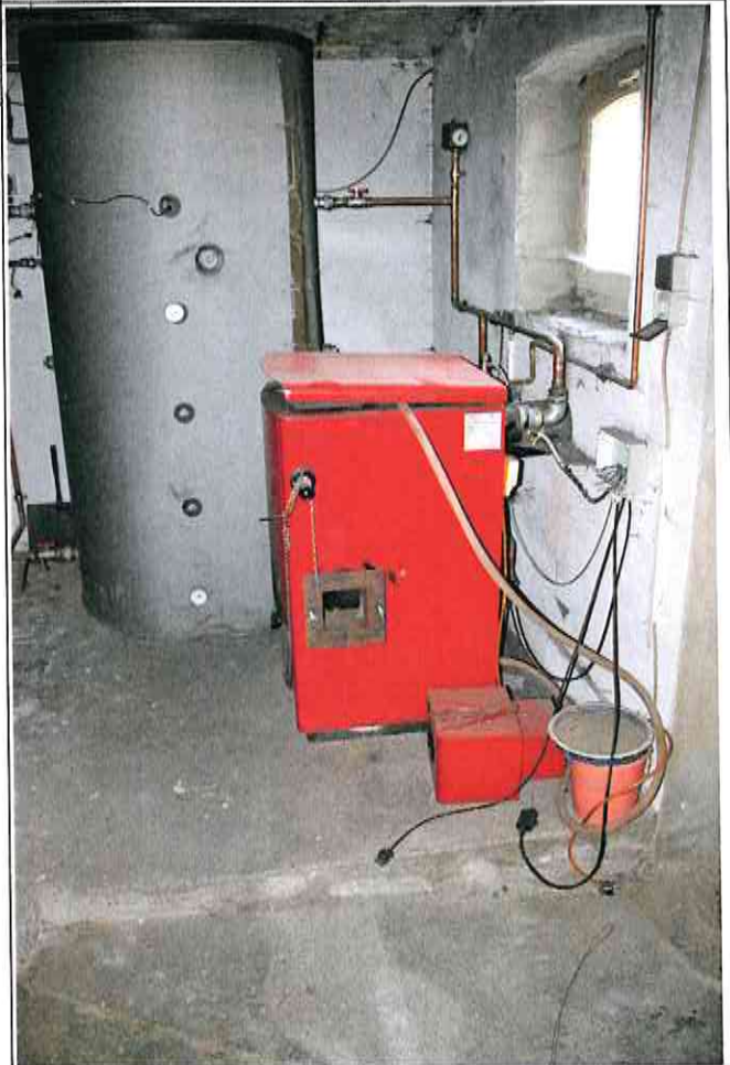
Wohnhausanbau Erdgeschoss Heizungsraum
