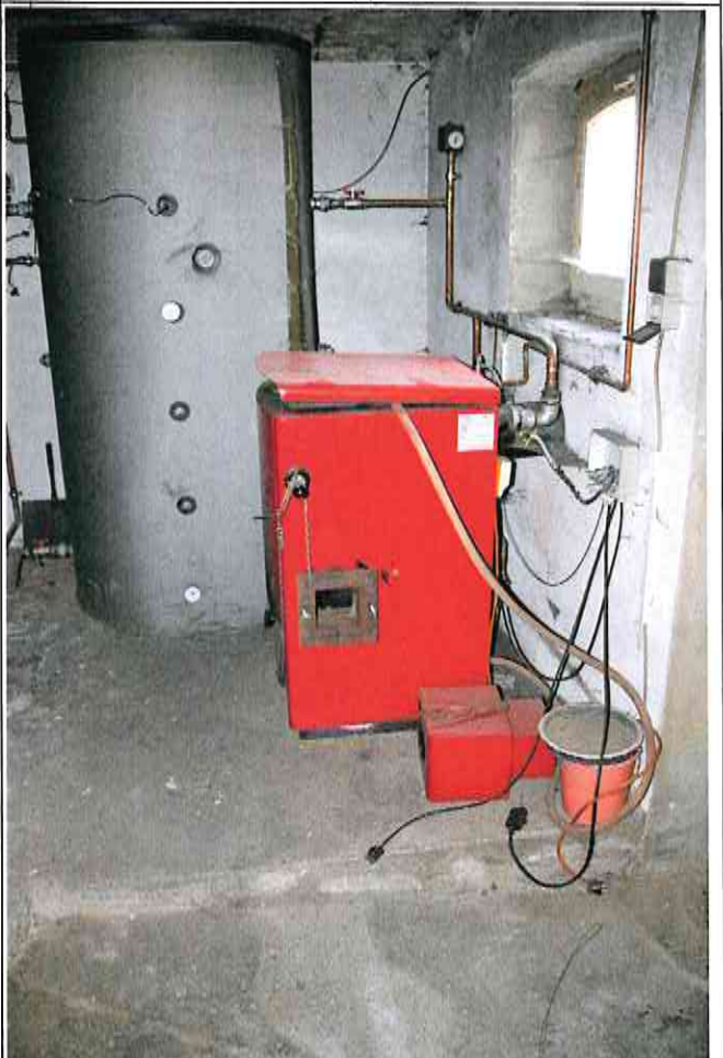
Wohnhausanbau Erdgeschoss Heizungsraum
