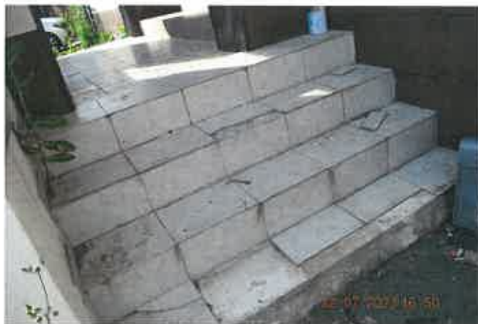
Eingangsbereich, schadhafter Fliesenbelag
