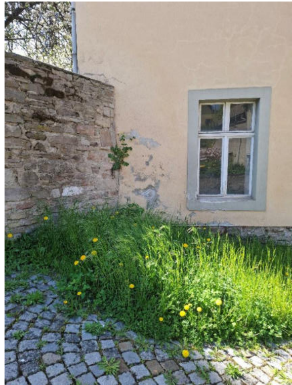
Feuchtigkeitsschäden an Südecke
