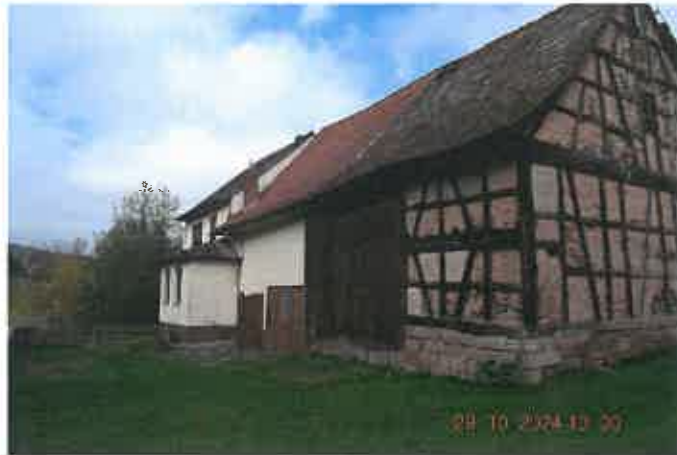
Scheunenansicht mit tlw. sich absenkendem Eckgiebelbereich
