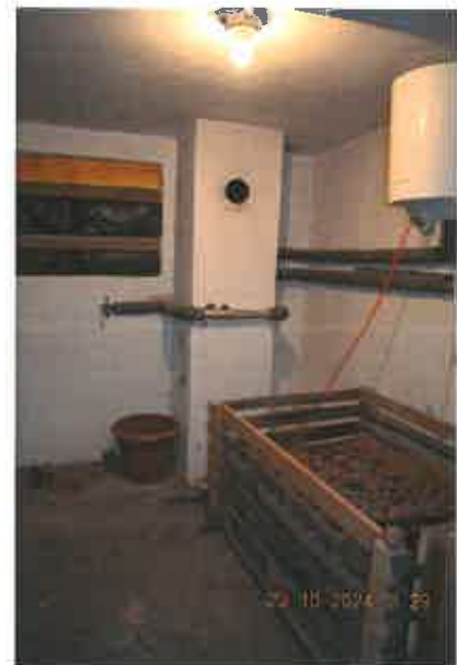
Kartoffellager mit WW-Boiler für Bad im Wohnhaus
