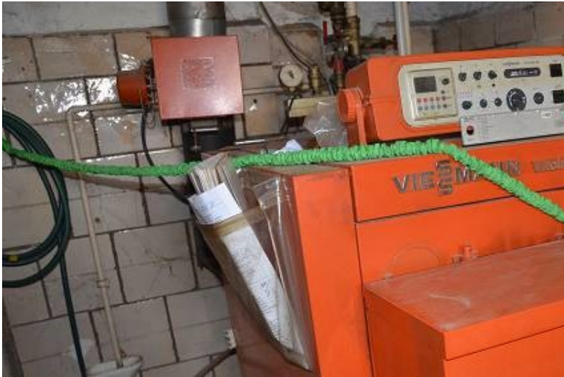
Foto 13 HEIZUNG IM KELLERGEBOOD
