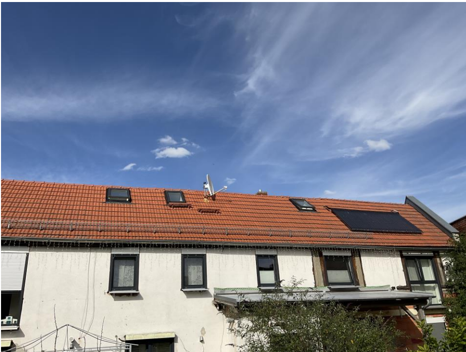
OG und Dachgeschoss mit Solarthermie
