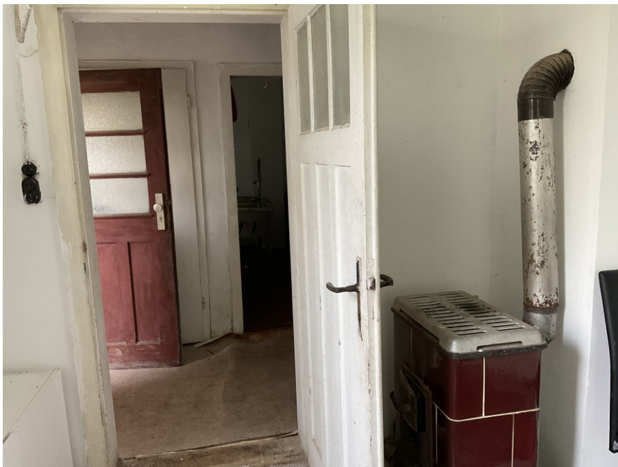
Ofenheizung, Elektro auf Putz, verschlissen,
