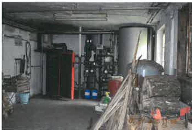
Heizungsanlage in Werkstatt
