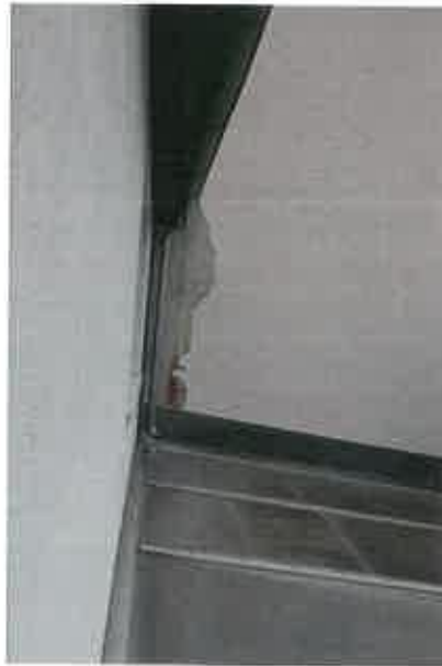
seitliche Putzschäden an der rückwärtigen Fassade
