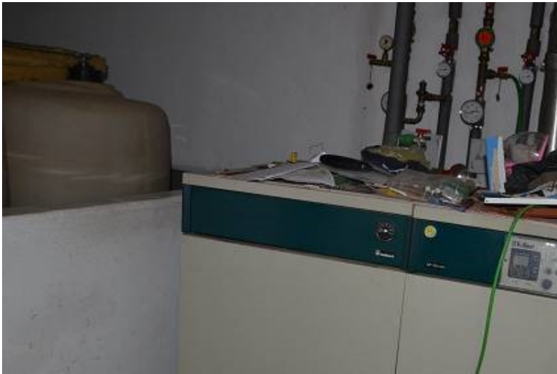
Foto 13 HEIZUNG MIT ÖLTANKS IM KELLER- GESCHOSS
