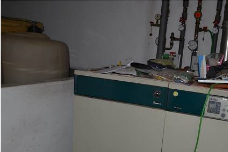
FOTO 13 HEIZUNG MIT ÖLTANKS IM KELLER- GESCHOSS
