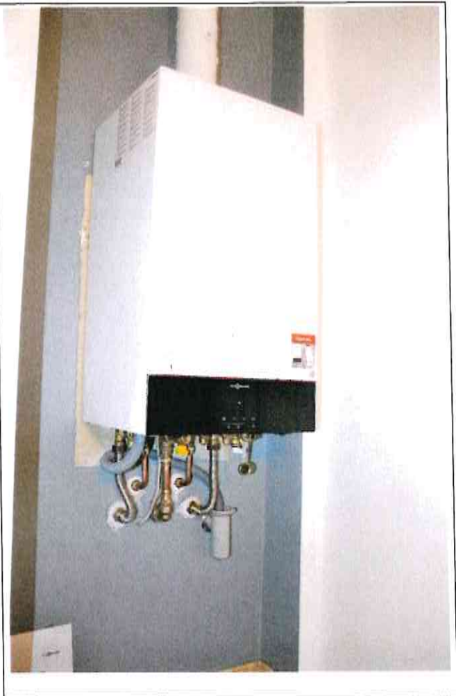
Wohnung D/1 Spitzboden Heiztherme
