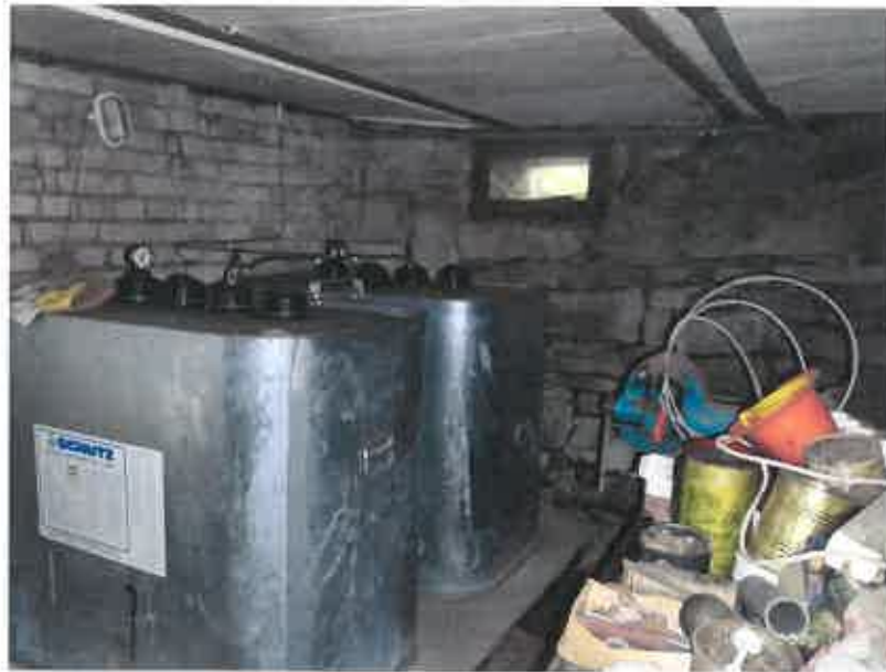
Öltanks im Keller
