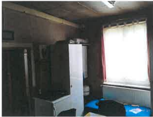
Raum Erdgeschoss mit Gastherme
