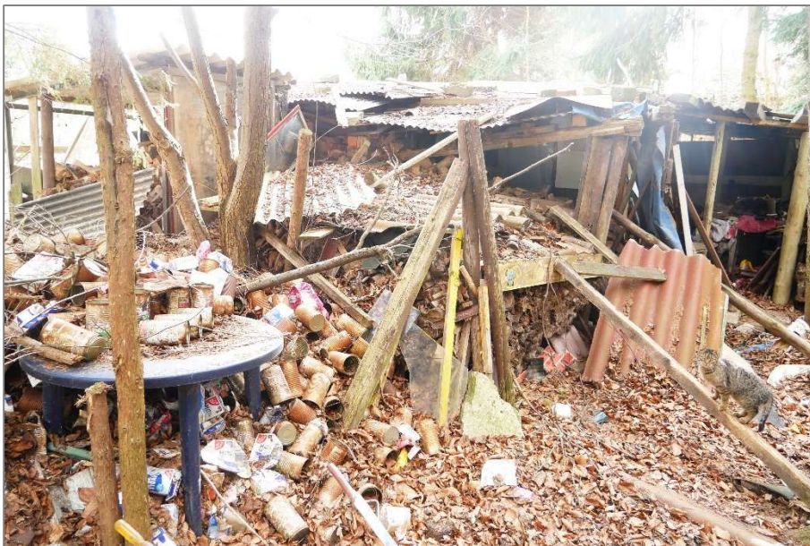
Flurstück 754/1 - eingestürzte einfache Schuppen und Ablagerungen
