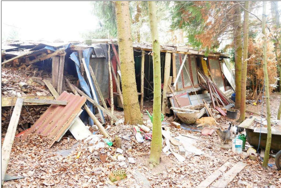
Flurstück 754/1 - teilweise eingestürzte einfache Schuppen
