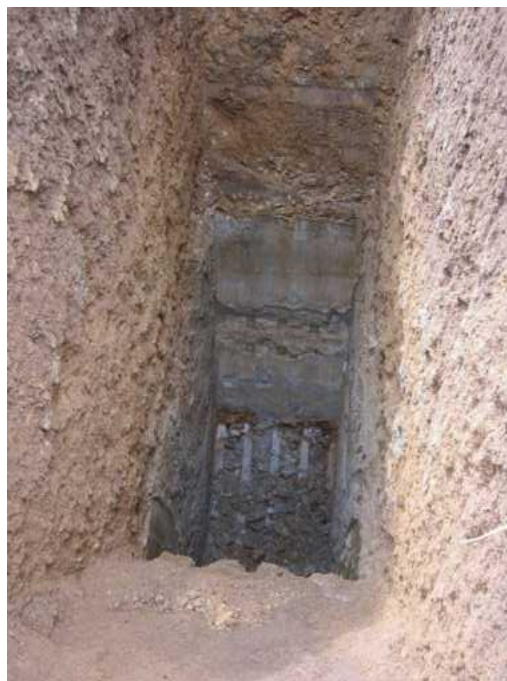
Foto 32: Schurfgrube Schurf S12
