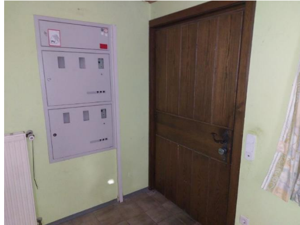
Abbildung 43: Verteilerkasten neben der Eingangstüre
