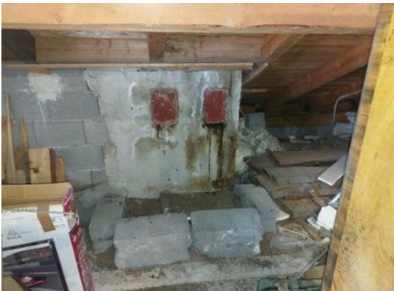
Abbildung 19 Aussinterungen Risse am Kamin
