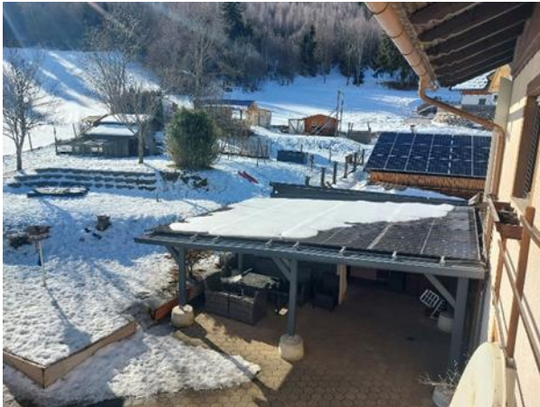
Abbildung 57 Überdachte Terrasse illegal
