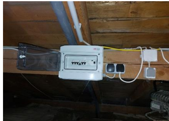
Abbildung 20 Untersicherungskasten kein E Attest
