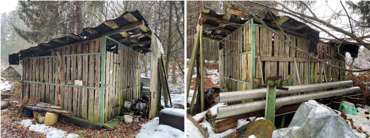
baufällige Scheune im westlichen Bereich des Grundstückes
