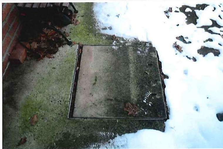
Bild 9: Regenwasserspeicher im Bereich des südlichen Sondernutzungsrechts von Teileigentum Nr. 5
