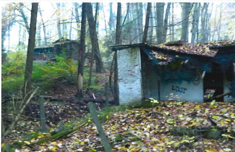
Bild 6: Bauruine am Rande des südlichen Nachbargrundstücks
