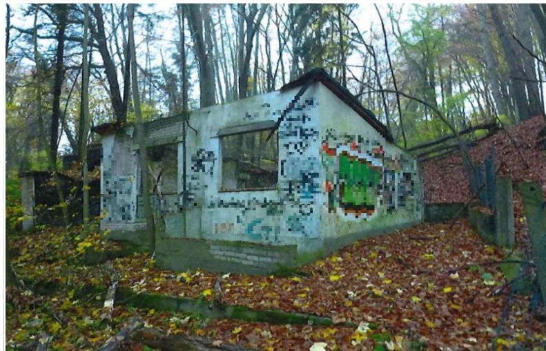
Bild 5: Bauruine – Abriss erforderlich
