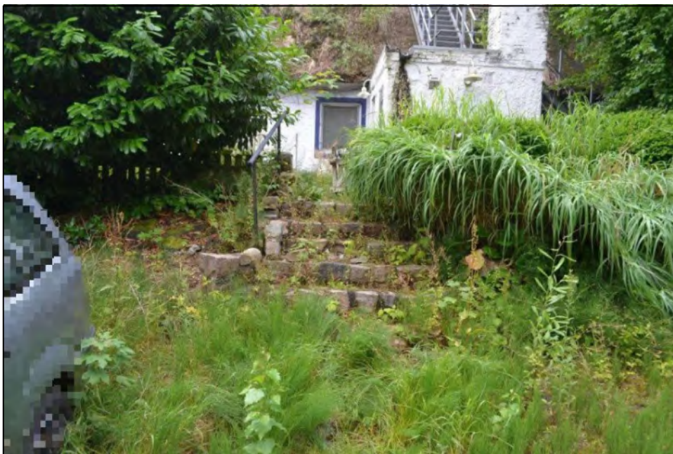
Bild 10: Treppenaufgang zum Gebäude (nicht verkehrssicher begehbar)
