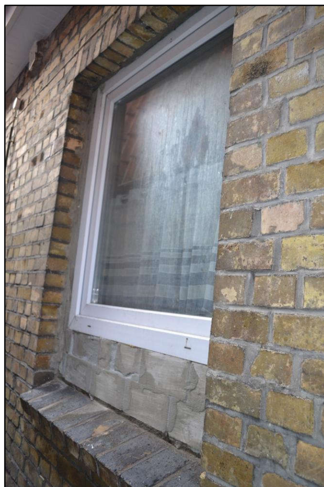
Bild 10: EG-Fenster als Detailaufnahme (gem. Grundriss Küche)
