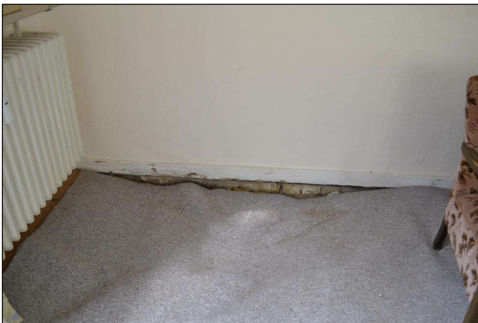
Bild 32: Fußboden (eingebrochen) als Detailaufnahme
