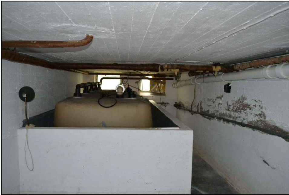
Bild 37: Kellerraum 2 mit Heizöltanks
