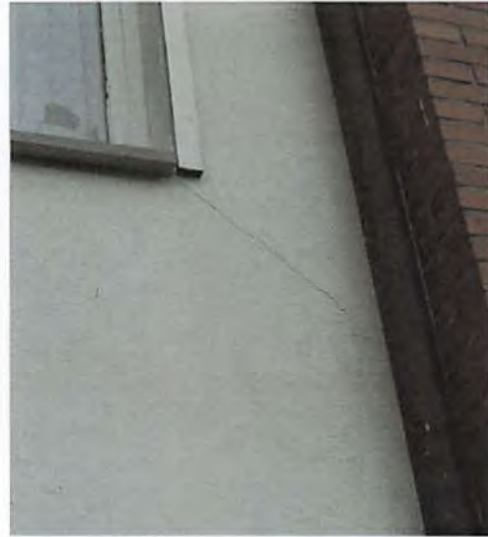
Bild 14: Situation Rissbildung Fassade eingangsseitig
